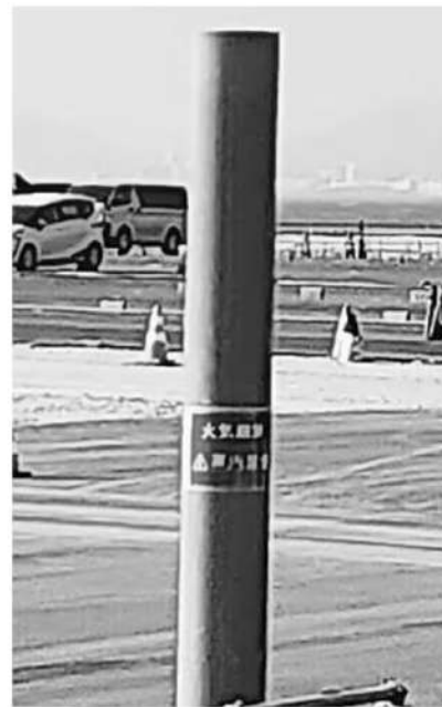
「火気厳禁」と書かれたガス抜き管
